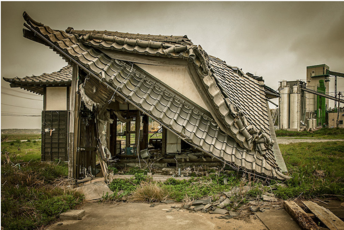
Une maison de la municipalité de Minamisoma, dans la préfecture de Fukushima, en mars 2014.
