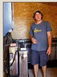
Vincent Arcusa devant les batteries stockant l'énergie solaire.
