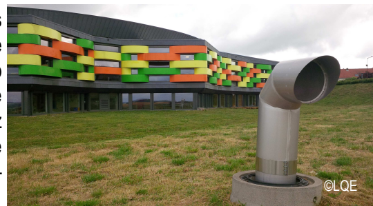
Entrée d'air du puits canadien
